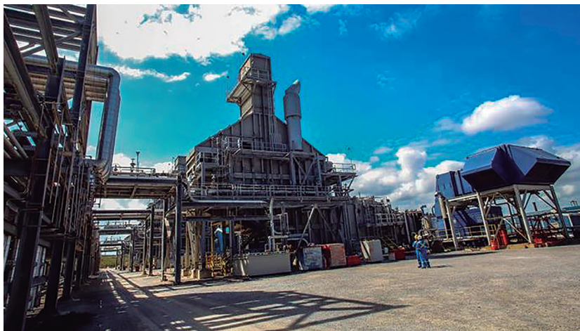
Fig. 5.40 Instalaciones de la central eléctrica de ciclo combinado Energas en Boca de Jaruco
